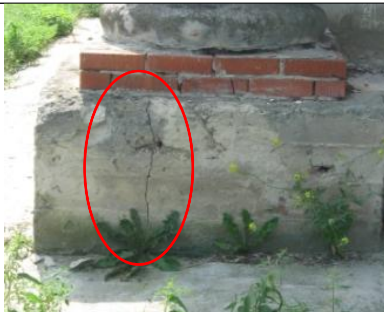
Трещина цоколя, близкая к вертикальной, с одинаковым раскрытием по высоте, ширина раскрытия до 4 мм
