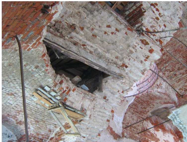
Обрушение столпа, арок и сводов
