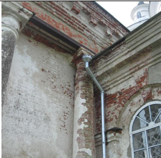
Выветривание раствора, разрушение поверхностного слоя кирпичной кладки пилястры
